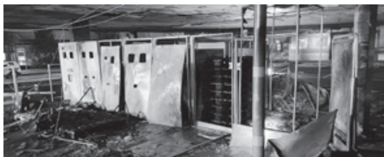
Von diesen Entsorgungsbehältern ging der Brand aus.
